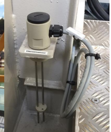
Wassermelder im Ponton
