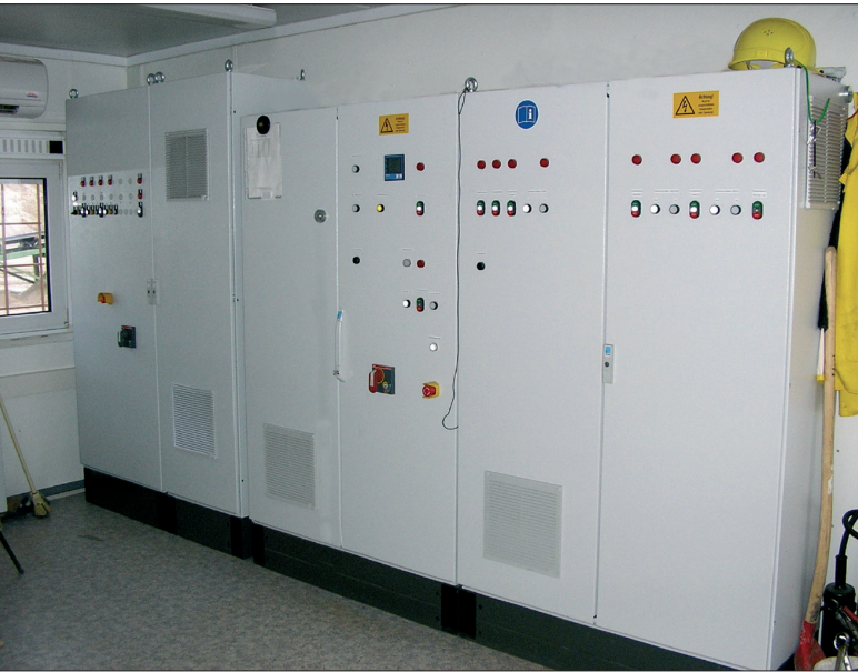
E-Container – Schaltfelder von Dosieranlage und Tunnelabzug
